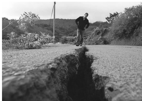
图 1-5 哥斯达黎加 6.2 级地震造成的地裂缝
