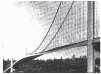
(c) 变形过大的桥面梁
